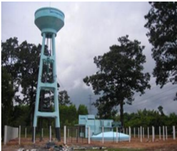
หอถังสูงขนาด 30 ลูกบาศก์เมตร และระบบกรองน้ำประปาผิวดิน
