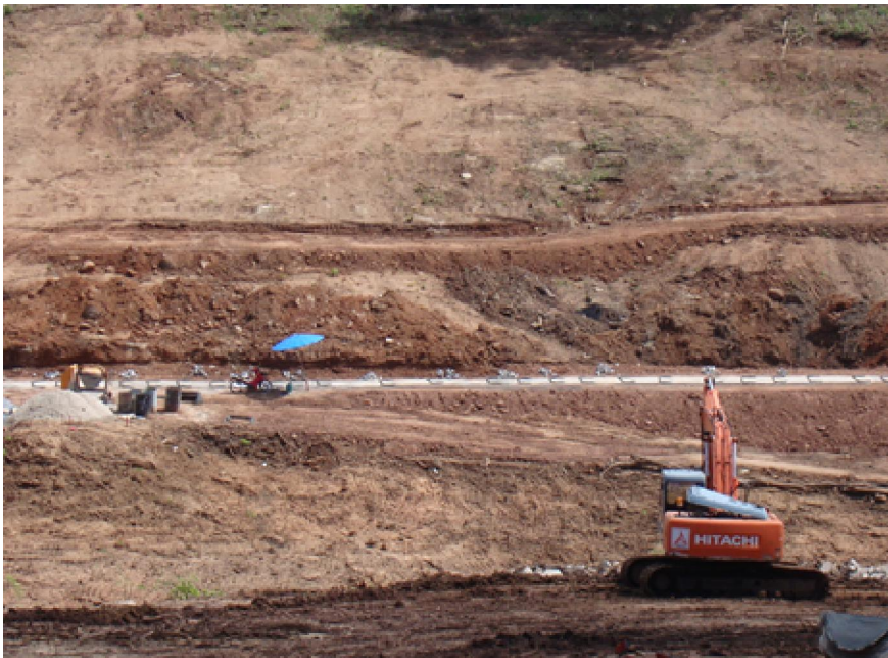
พื้นที่ดำเนินการก่อสร้างอ่างเก็บน้ำห้วยโพนเพ็ก ขณะนี้ดำเนินการขุดเปิดหน้าดิน บริเวณปู CLAY BLANKET
